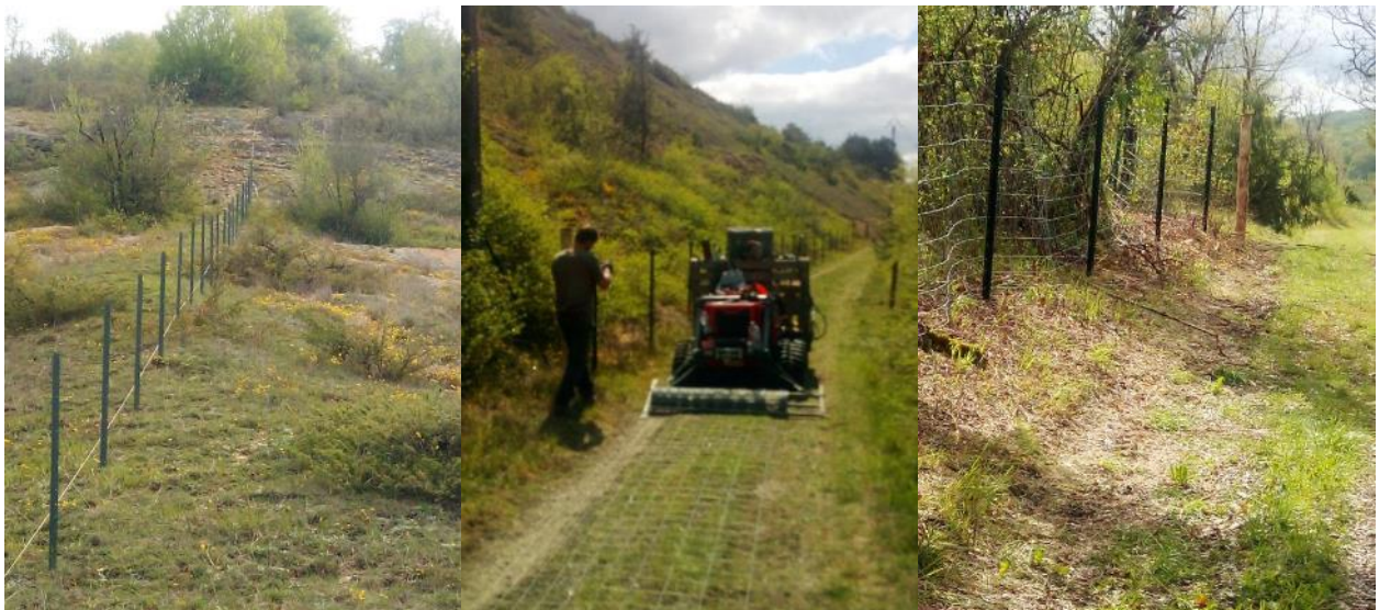
Figure 10 : Pose du fil de tension / Déroulage des rouleaux de grillage ursus / Pose du grillage ursus
