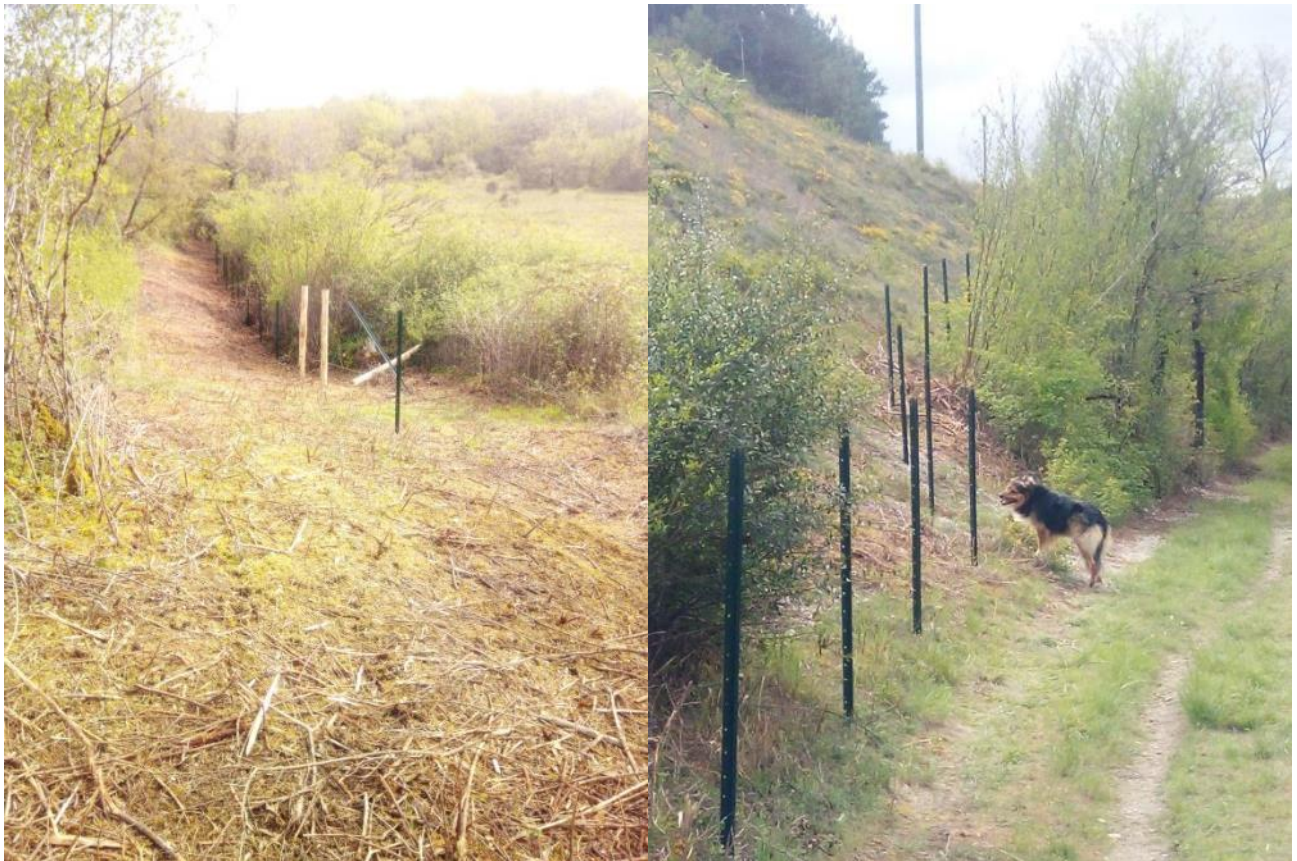
Figure 9 : Vue après la création des layons et début de mise en place des piquets fer
